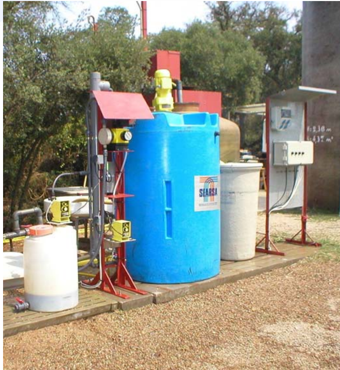
Detalle de los equipos del tratamiento físico-químico
