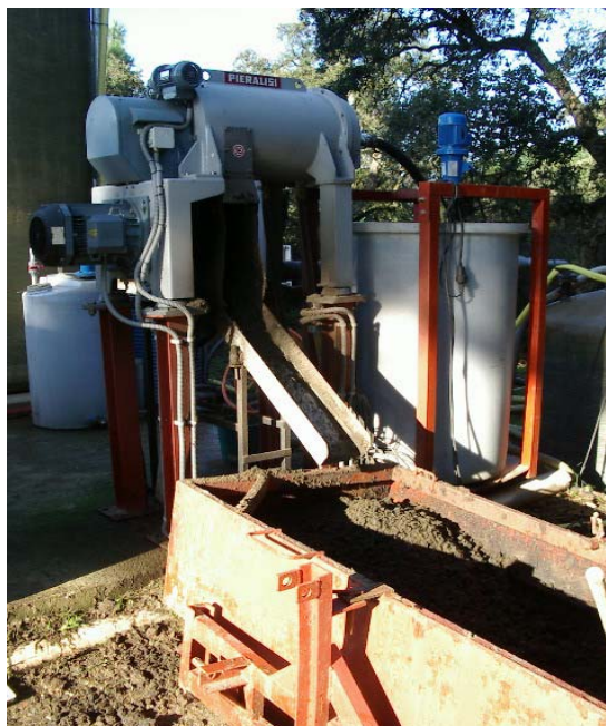
Detalle de salida de la centrifuga y almacén del
