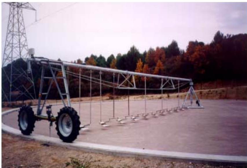
Vista parcial del tratamiento secundario por infiltración - percolación de Els Hostalets de Pierola (Barcelona)
